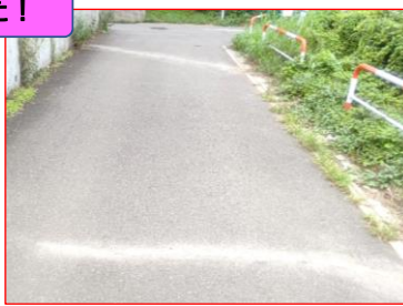
岸町三丁目地内 久保川沿い豪雨での越水によるヒビ割れ補修を要望しました。
